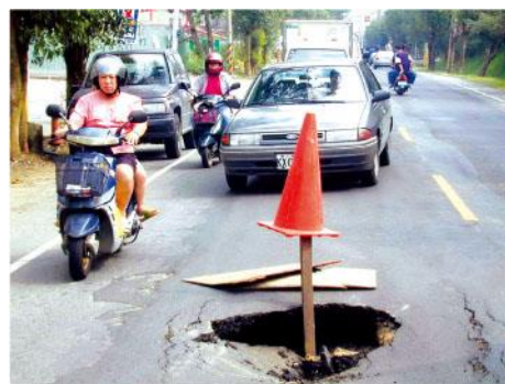
▲圖 1-3-3 在生活周遭常有各種修築道路或建築工程，若我們對施工單位未依法豎立安全標誌的情況視而不見，就可能釀成交通事故。
